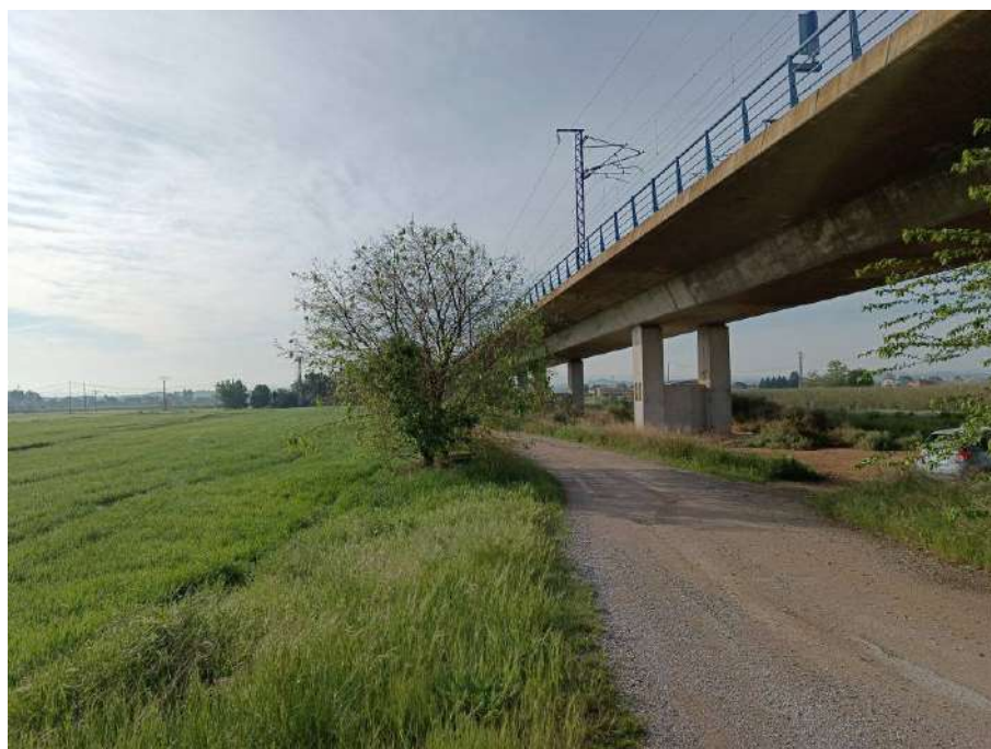
Aspecte del punt P10 pel cantó nord de la línia de l'AVE
