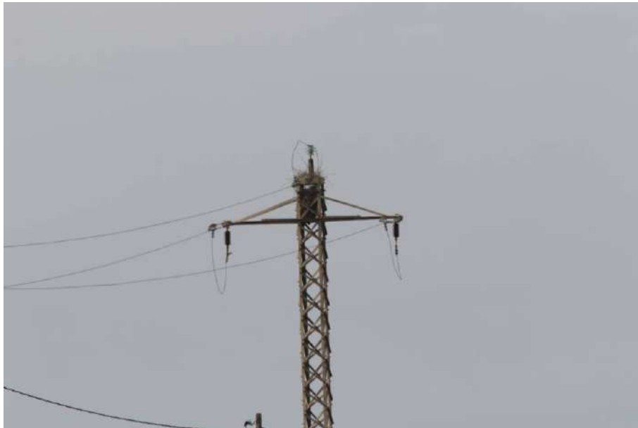
Niu de garsa sobre una torre elèctrica de baixa tensió
