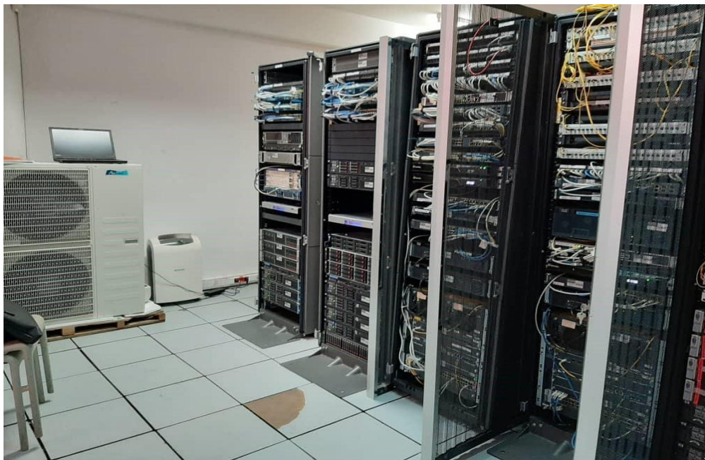
Photo 3 : Salle du serveur de la présidence
