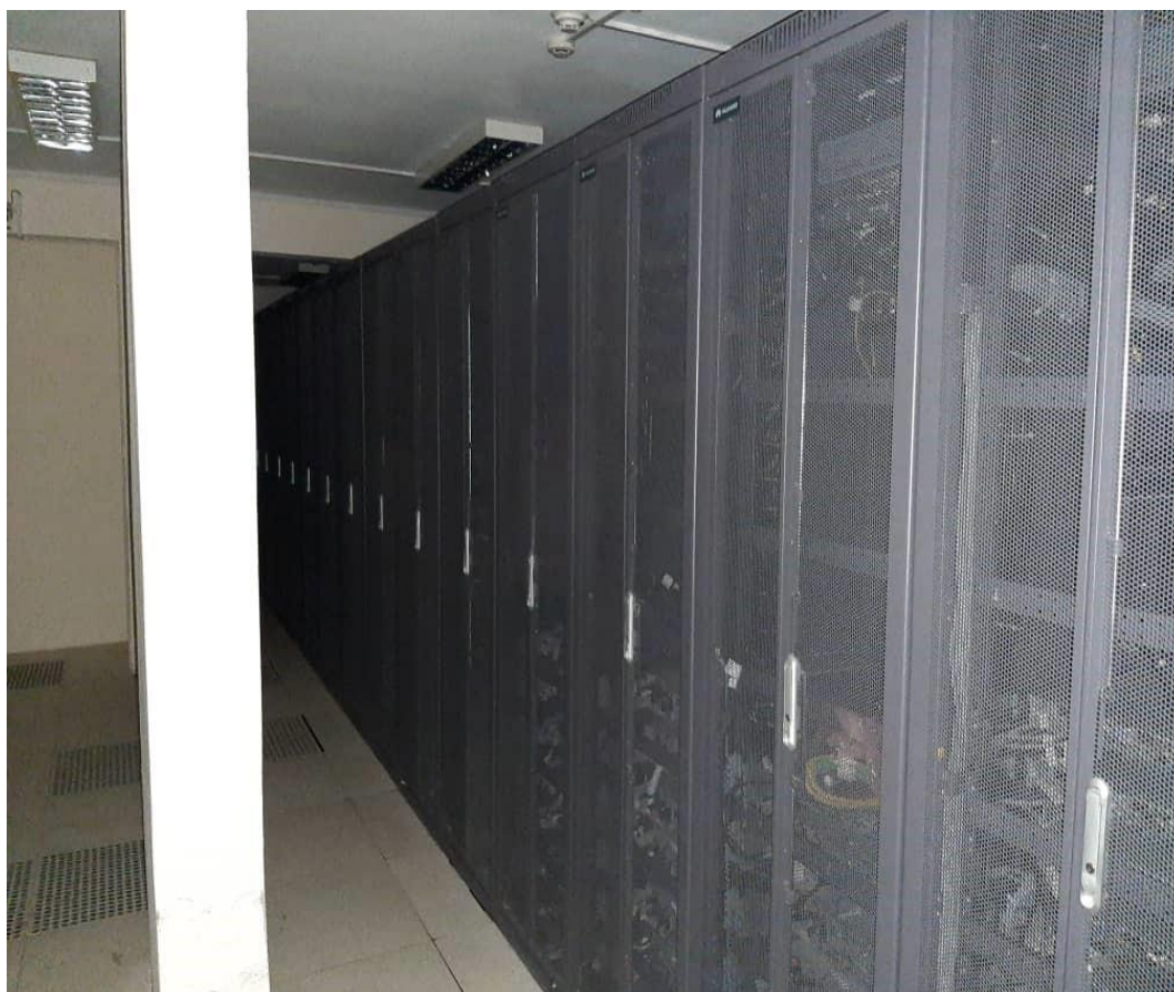
Photo 2 : Salle du serveur du Datacenter de Grand-Bassam
