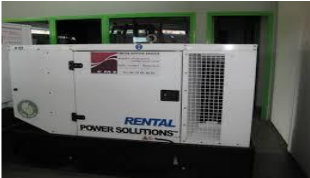
Figure 37 : Exemple de groupe électrogène de Datacenter
