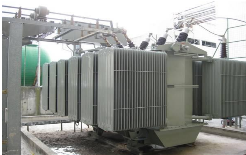
Figure 34 : Exemple de transformateur de Datacenter
