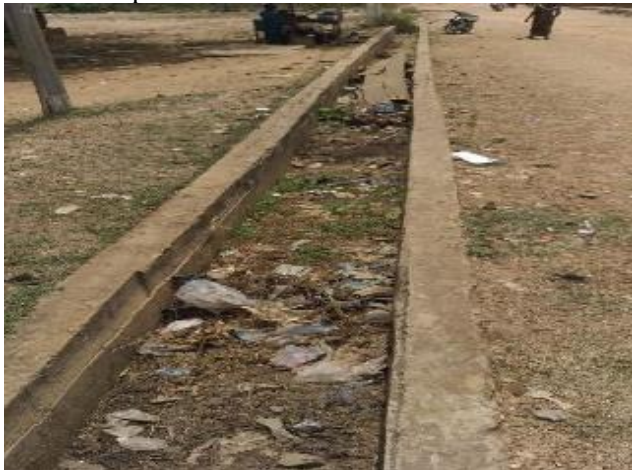
Photo 17 : Image des canalisations de la ville de Béoumi exposées à l'ensablement
