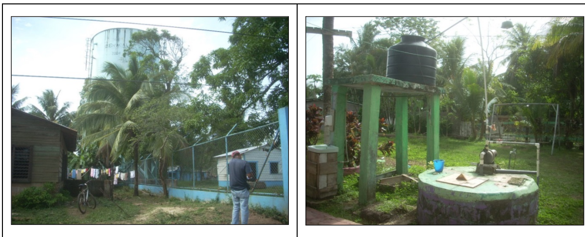
Figura No. 1: Depósito de agua potable de ENACAL y pozos y tanques de almacenamiento para el suministro de agua potable en la ciudad de Bilwi.
