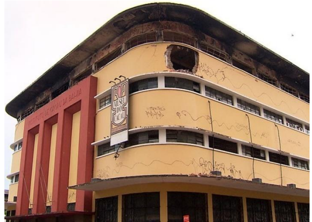
Figura 33 – Estrutura do Instituto de Cacau da Bahia que caiu após incêndio — Foto: Reprodução/TV Bahia.
