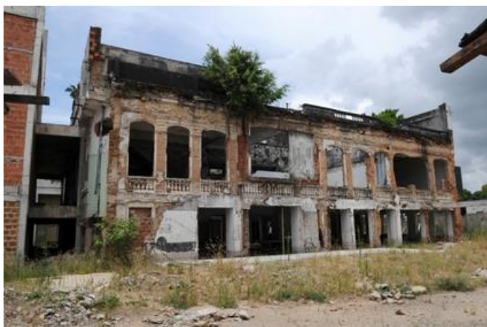
Figura 38 – Visão parcial da parte posterior da Antiga Fábrica da Fratelli Vita. Foto: Elias Mascarenhas (IPAC)
